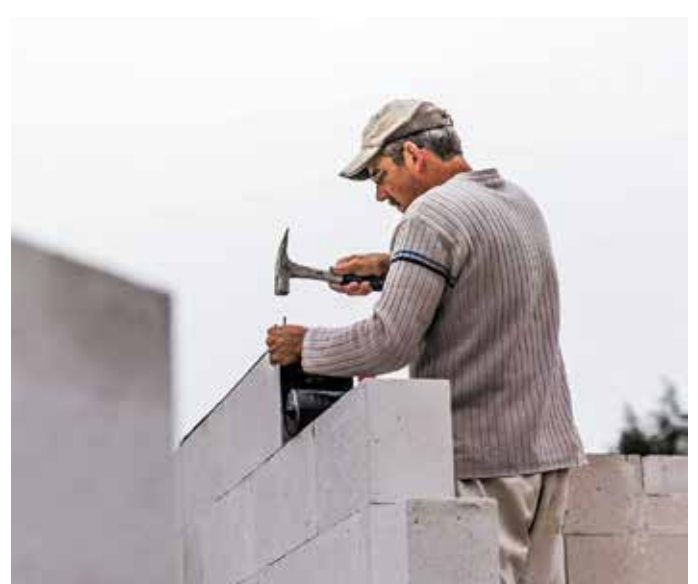
Die hohen energetischen Anforderungen an den Neubau machen das Bauen fehleranfälliger und teurer. Foto: DJD/Bauherrenschutzbund/Marko Priske
