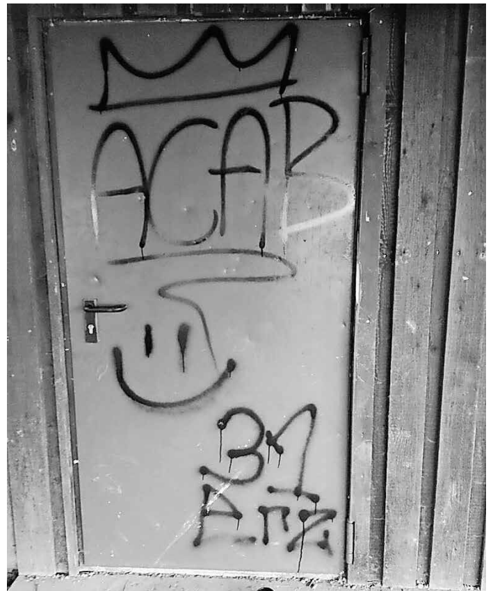
Einen kleinen Teil der Verschmutzung sieht man hier
