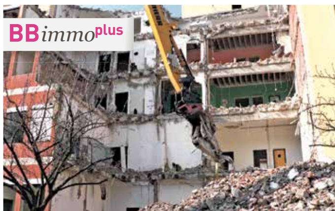
Sanierungswürdig oder nicht – manchmal hilft nur Abriss.
