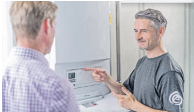
Bei der Planung einer neuen Heizung ist es wichtig, dass Technik und Auslegung perfekt zum Gebäude passen.
