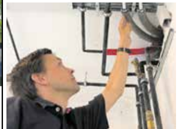
Leitungen in Altbauten sind meistens zu erneuern, wenn nicht in jüngerer Zeit bereits saniert wurde
